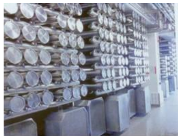
б – Ультрафльтрационная установка
